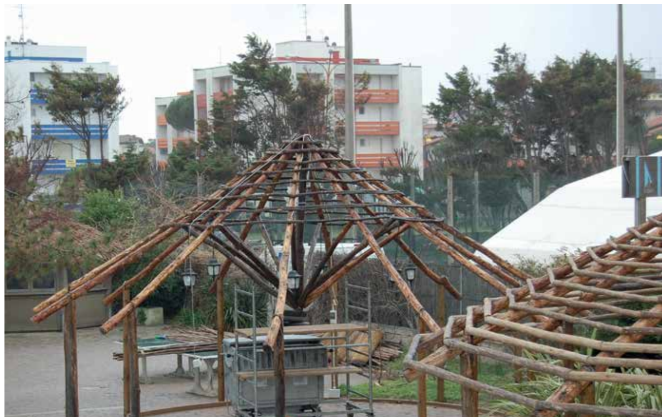
Fase 1. Realizzazione struttura primaria portante in Eucalyptus Sudafricano / Step 1: South african Eucalyptus Grandis main frame
